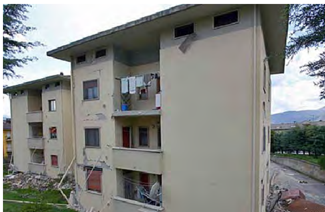
Fig. 2.6.3 > Chute du parapet de l'étage supérieur
