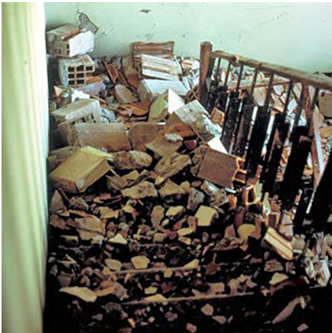
Fig. 2.7.3 > Décombres obturant une volée d'escaliers
